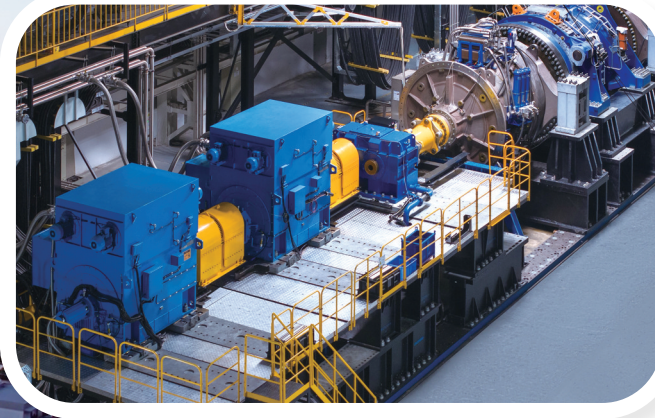
▲图为远景齿轮箱弯扭耦合系统测试台。 ▲图为江阴远景智慧风电测试验证中心。
