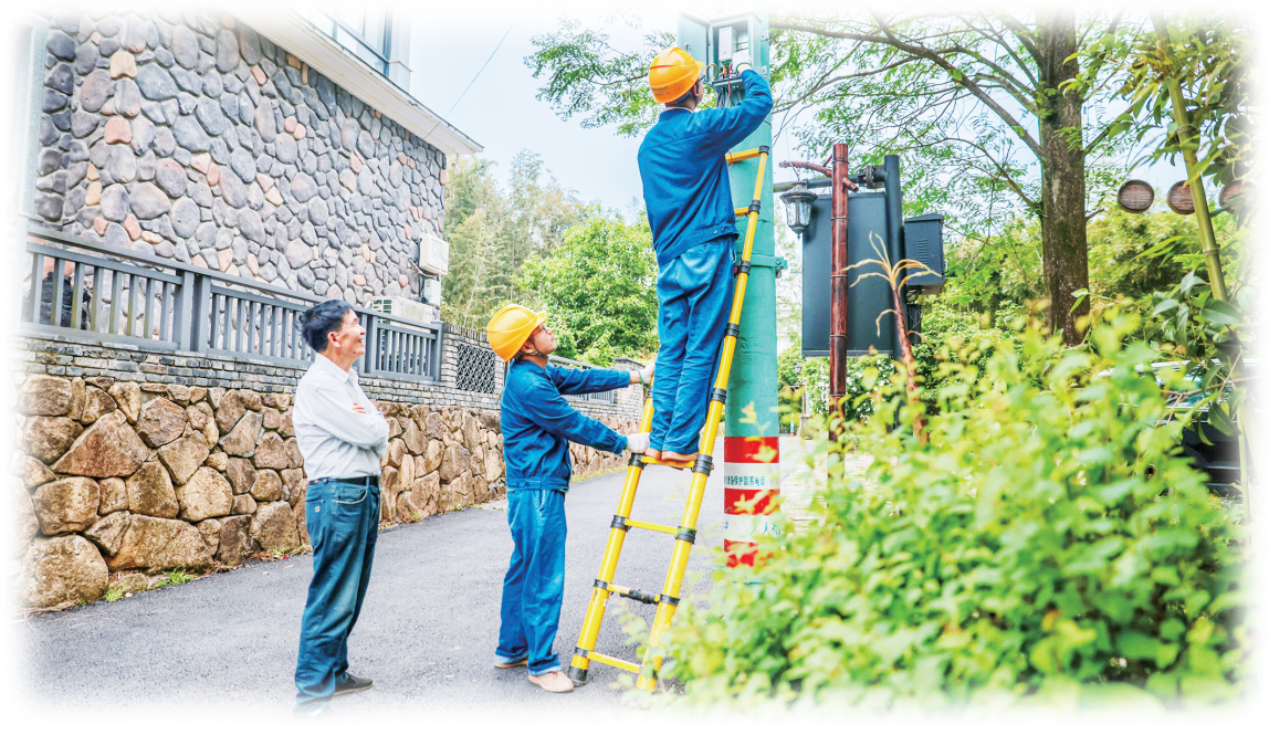
图为国网杭州市余杭区供电公司员工到小古城村部署LTU物联感知终端。张德峰/摄
