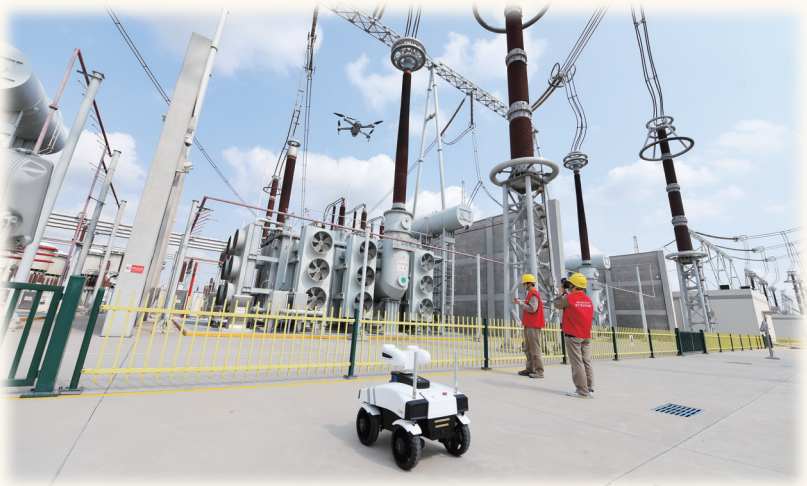
图为国网天津高压公司运维人员在1000千伏特高压海河变电站使用巡检机器人开展设备巡检。
