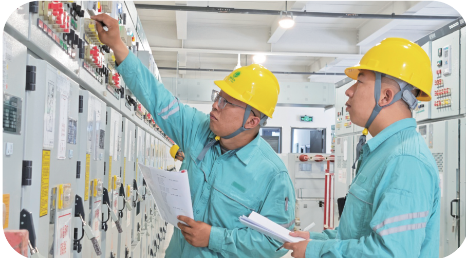
图为5月29日,隰县公司变电运检班马华建、闫睿智检查开关柜保护压板,完成设备投运前准备工作。
