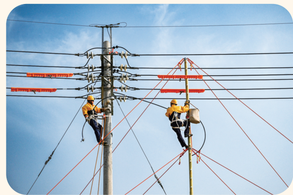
图为国网沈阳供电公司人员在电杆上开展引流线搭接工作。 陈龙/摄
