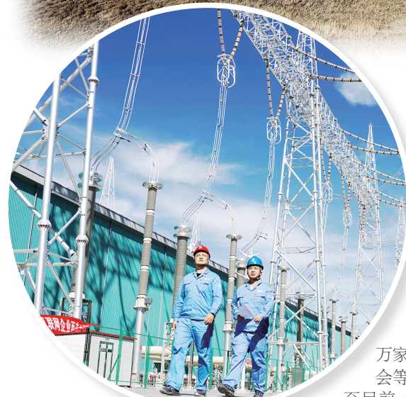
国网青海电力工作人员在±800千伏特高压青南换流站巡视设备。王国栋/摄
