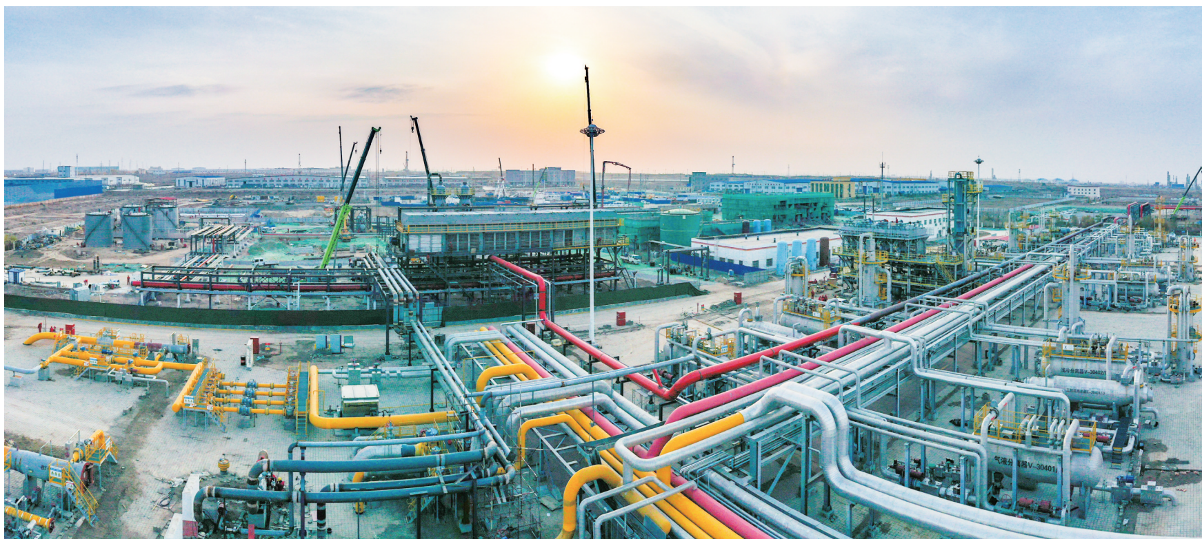
国内最大的天然气储气库——中国石油呼图壁储气库。赵凯/摄
