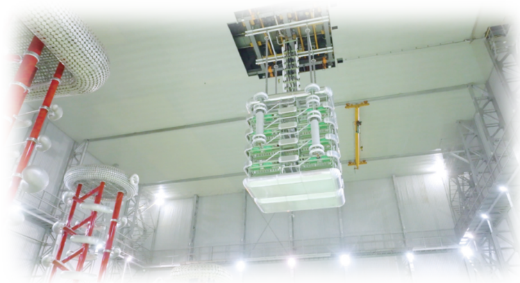
图为全球首台±800千伏/800万千瓦可控换相换流器。
