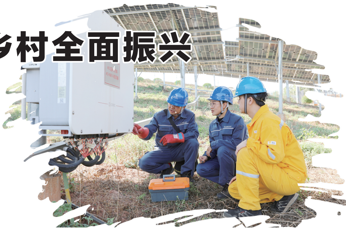
供电工作人员在新发“药光互补”电站检查并网设备,保障绿电稳定上网。
