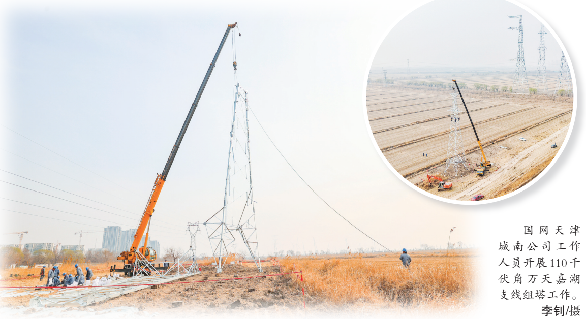
国网天津城南公司工作人员开展110千伏角万天嘉湖支线组塔工作。李钊/摄
