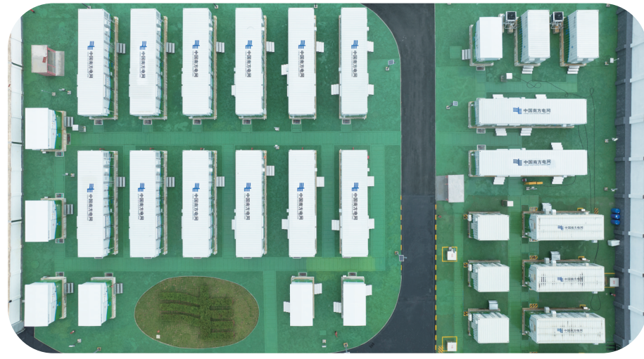
2025年10月,全国首个大容量钠离子电池储能电站——伏林钠离子电池储能电站二期扩容工程在广西南宁投入运营。
