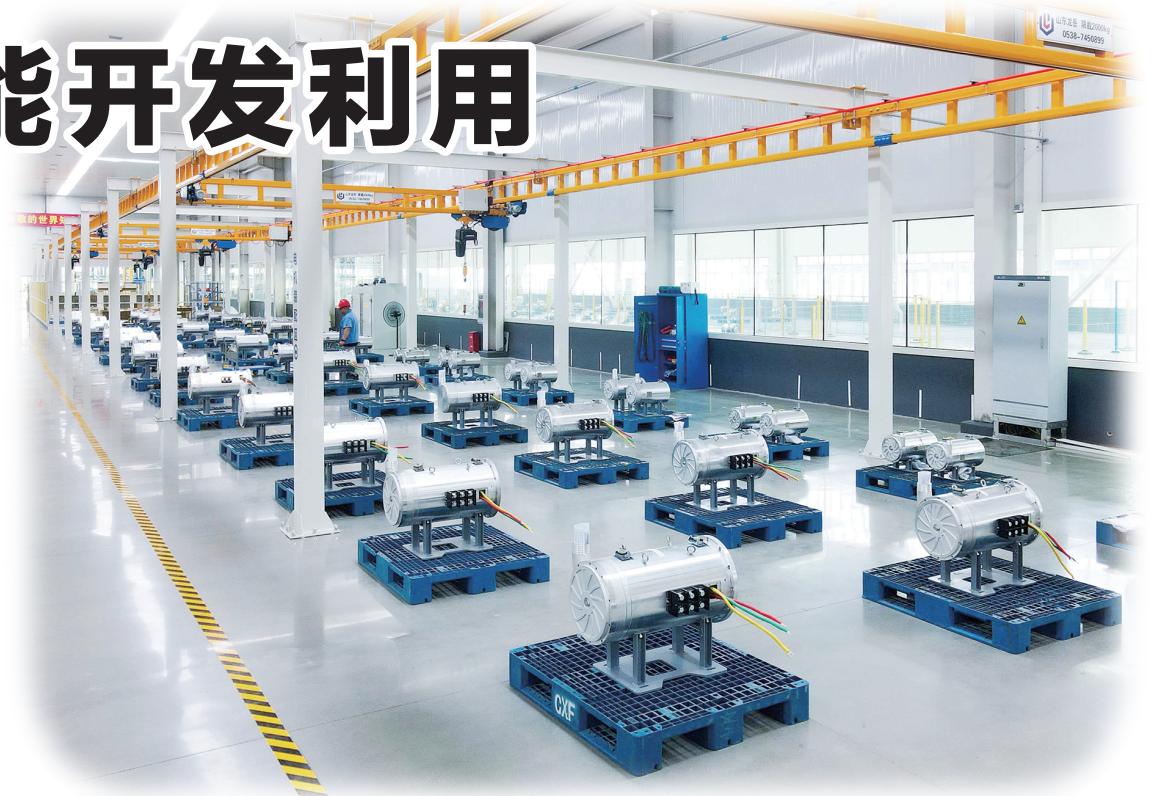
图为山东天瑞重工磁悬浮热泵生产车间现场。
