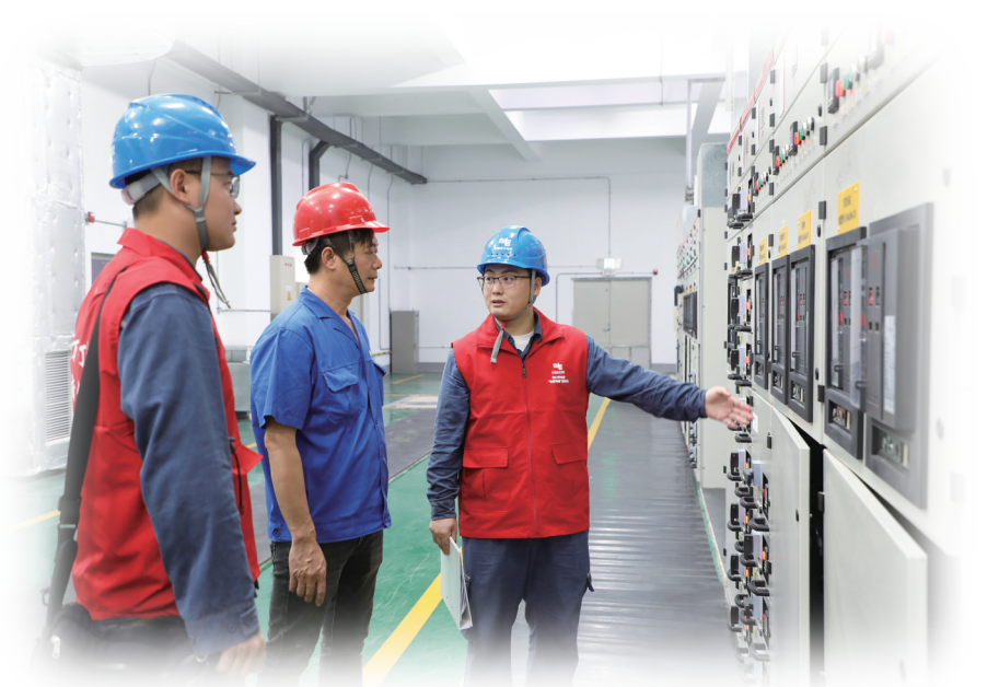
图为海口供电局组织工作人员走访椰树集团,为企业用电设备进行全方位“体检”。 杨永光/摄
