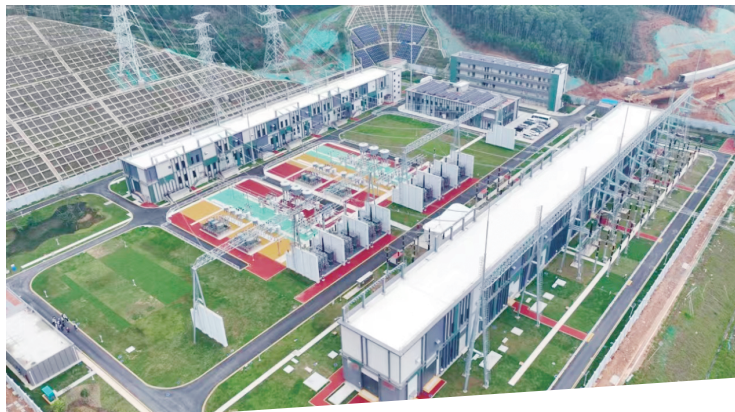
图为科北变电站。该变电站是全国首个“近零能耗”“双碳”示范变电站。南方电网广州供电局/供图
