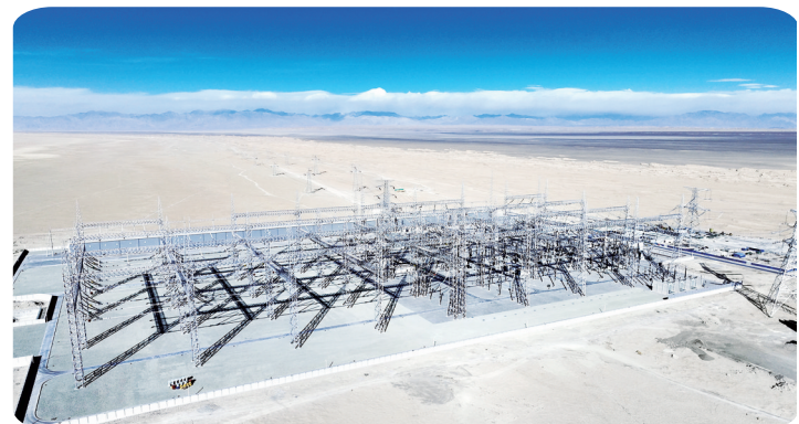
750千伏大漠变电站全景。张朋/摄
