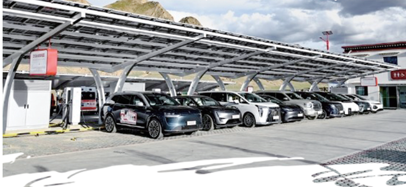
珠峰光储液冷超充站
