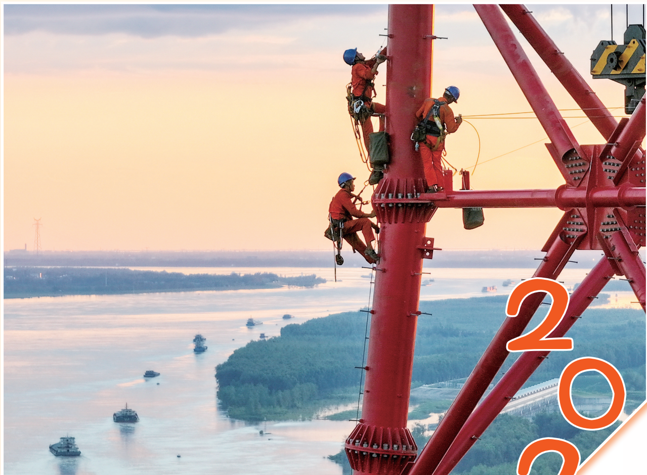
图为建设者开展金上一湖北±800千伏特高压直流输电工程N8302#立塔作业。项目建成后将成为首条大容量水光互补的纯清洁能源跨区外送直流通道。 王涛/摄
