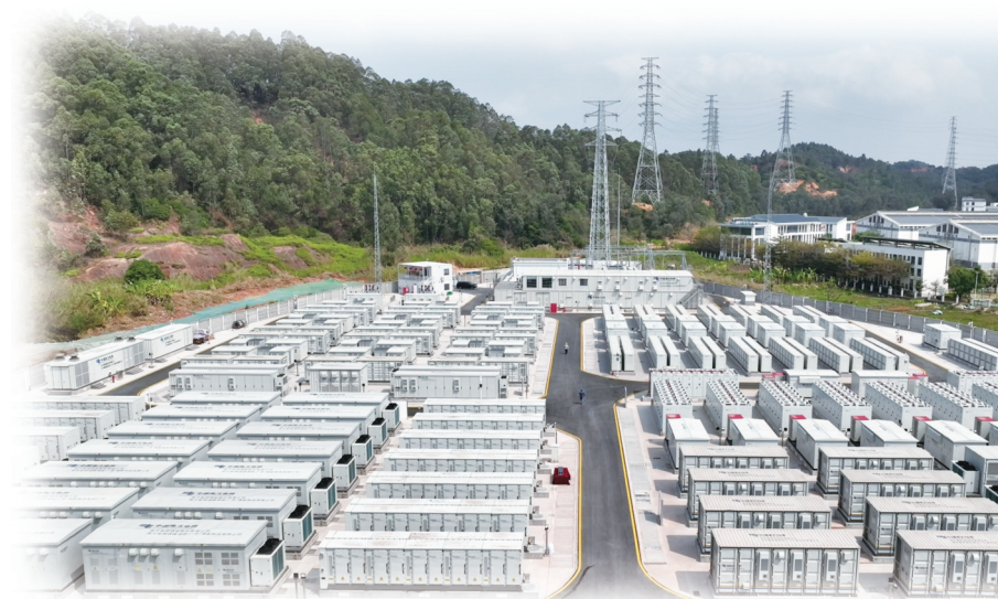
今年年初,南网储能投资建设的我国首个多技术路线锂电池储能站在佛山南海投入运行。
