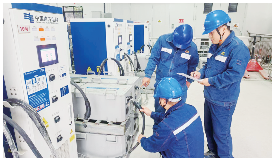
南方电网广西电动汽车公司工作人员在漓江兴坪电动竹筏充电站开展设备检查工作。黄高敬/摄
