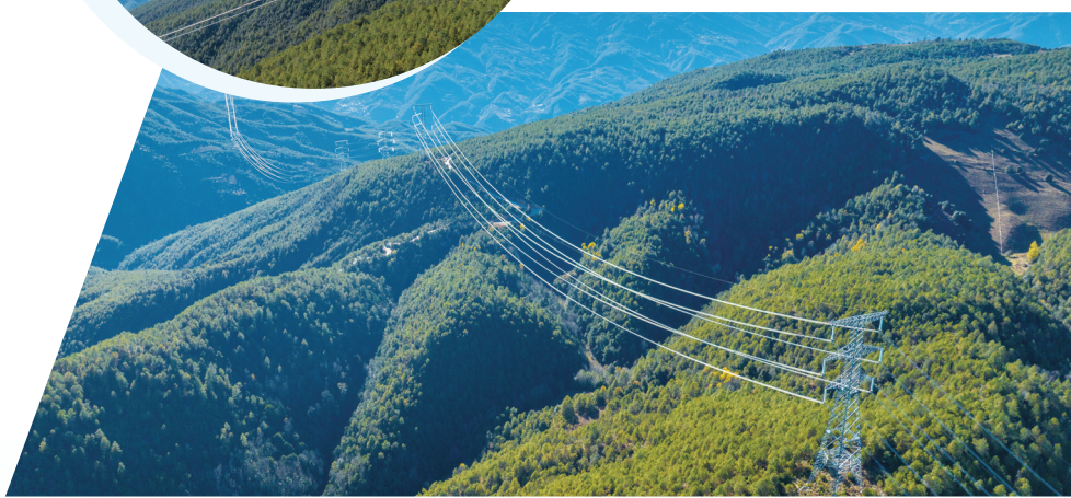
▲图为大理白族自治州剑川县马登镇郊外,将苗尾电站清洁水电接入±800千伏新松换流站的“西电东送”主干线路500千伏苗新甲乙线。
