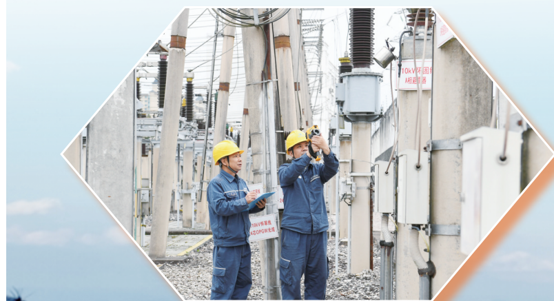
贵州电网公司凯里供电局工作人员对融冰装置进行测温。 龙定锦/摄
