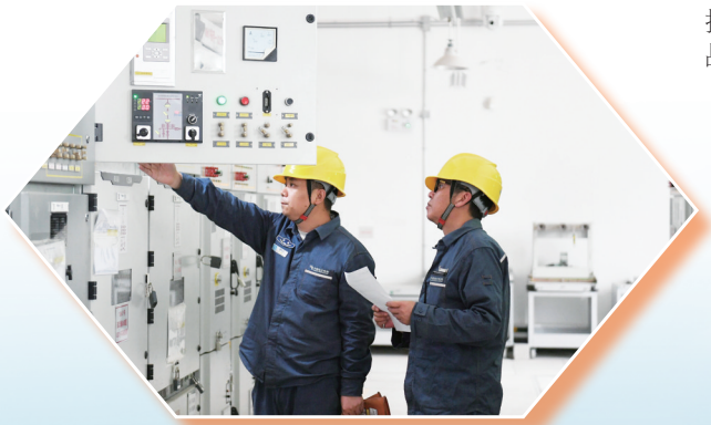
贵州电网公司凯里供电局工作人员打开智能融冰装置的电源开关。 龙定锦/摄
