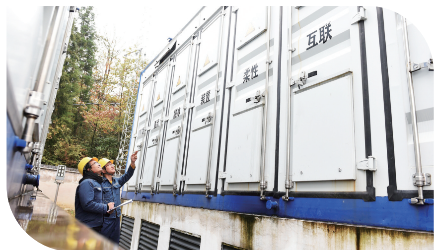
贵州电网公司毕节供电局员工对110千伏珠市变电站融冰装置开展巡视。 陈举/摄
