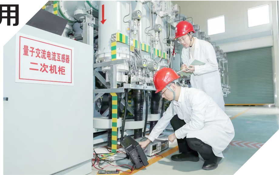
图为技术人员正在对量子电流互感器进行现场调试。
