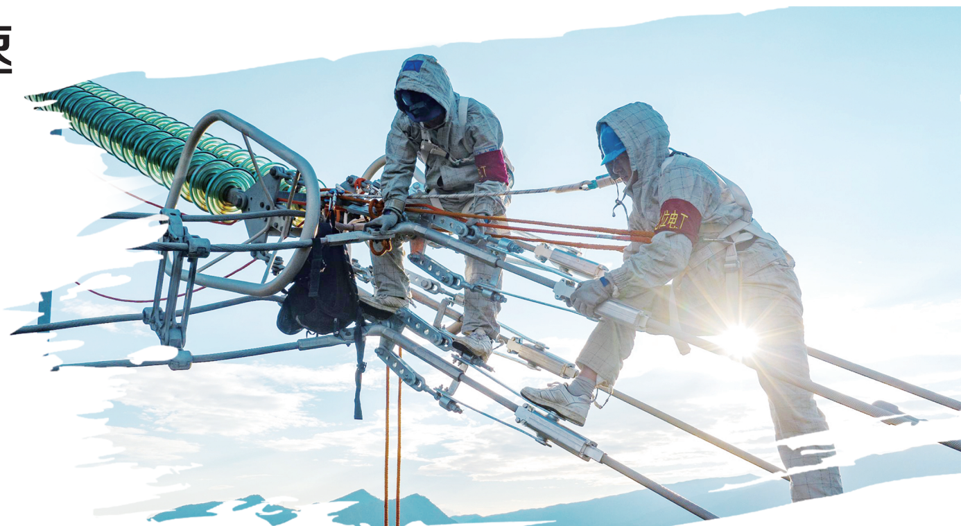
南方电网云南电网运维人员通过开展带电作业，加强线路精细化巡视和隐患排查，全力保障线路安全稳定运行。李超/摄
