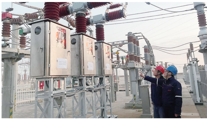
国网宁夏电科院专业技术人员正在进行设备带电投运前状态检查。戴龙成/摄
