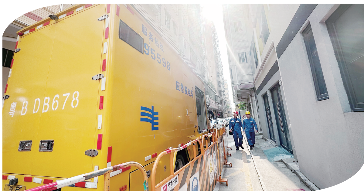
深圳龙岗大发埔村供电安全整治期间,供电人员采用应急发电车对施工片区进行临时供电,最大程度降低施工对居民的影响。
