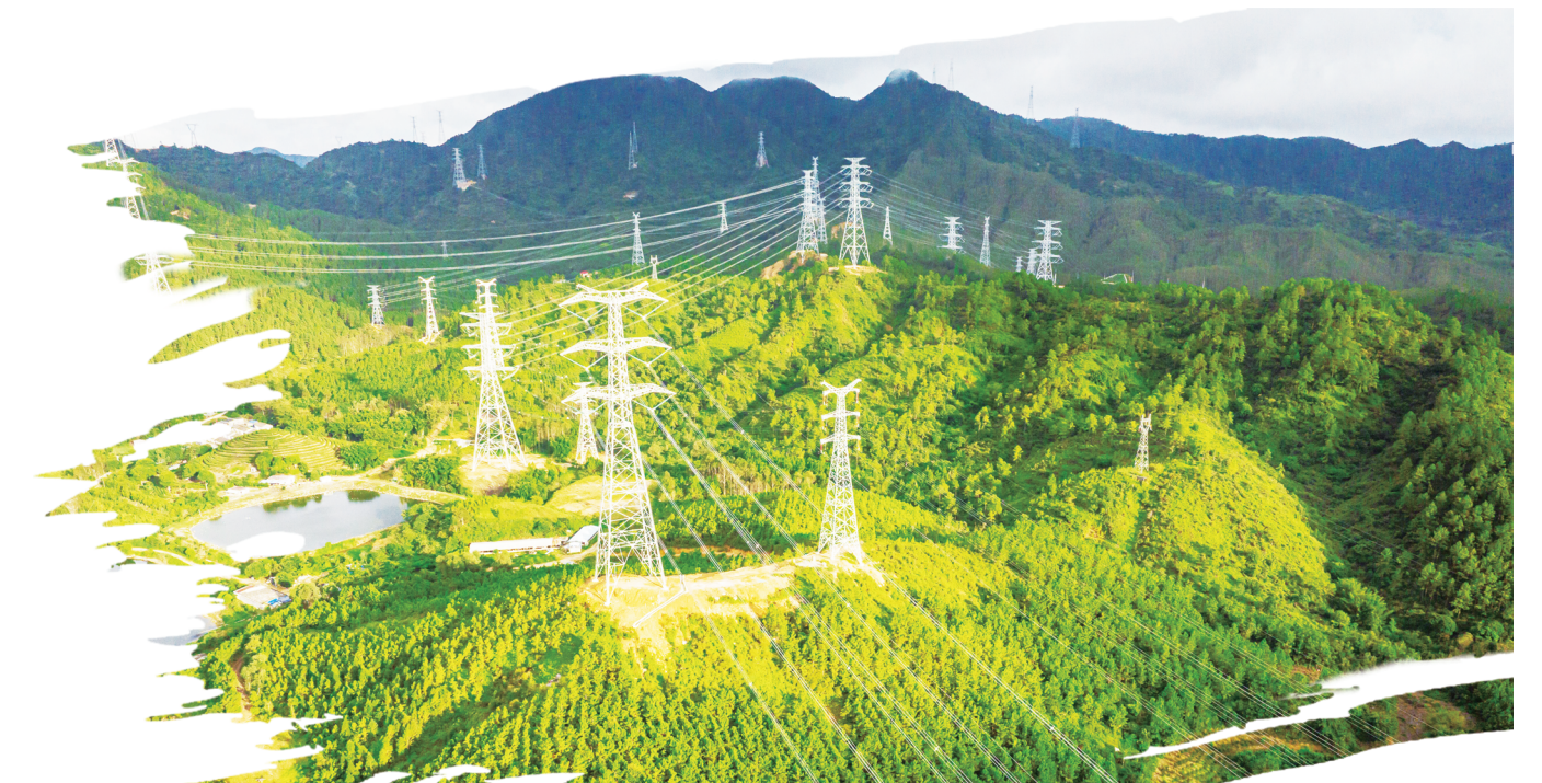
条条银线穿越山林,为深圳提供不竭电能。黄海鹏/摄
