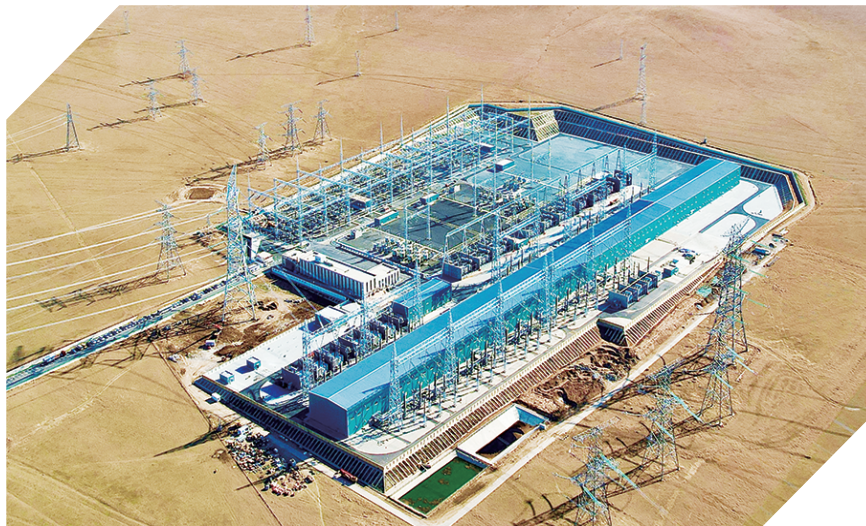
图为胜利1000千伏特高压站。
