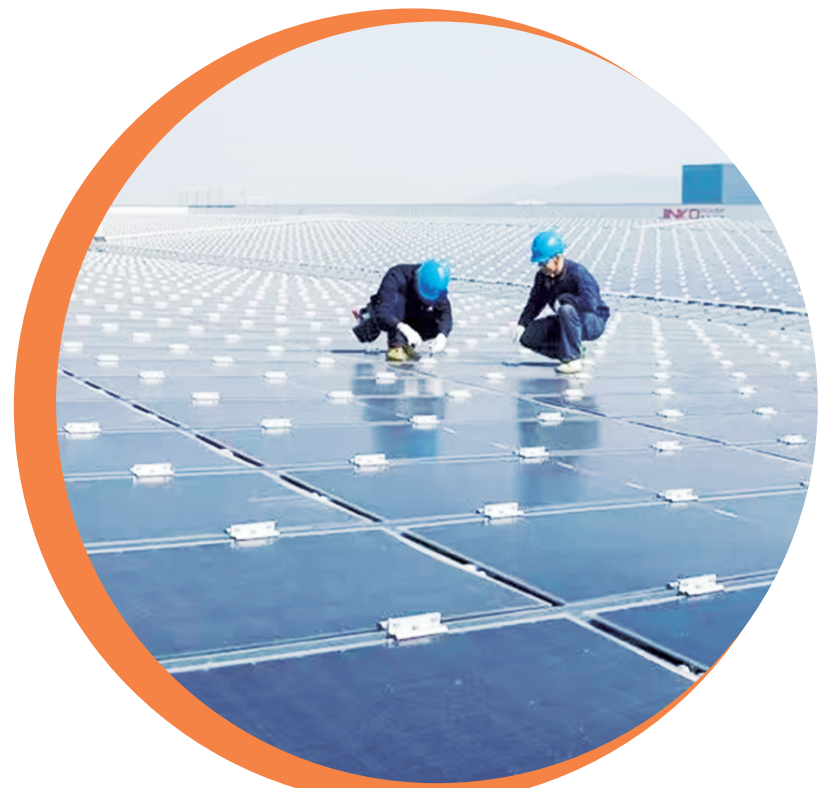
国网海宁市供电公司工作人员巡视企业光伏屋顶。潘洁/摄
