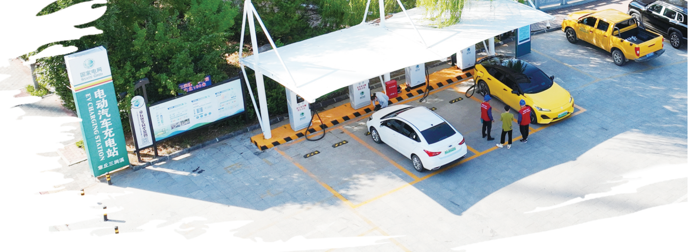
图为国网济南供电公司彩虹共产党员服务队队员到章丘区双山街道三洞溪村公共快充站开展设备巡视。刘超/摄
