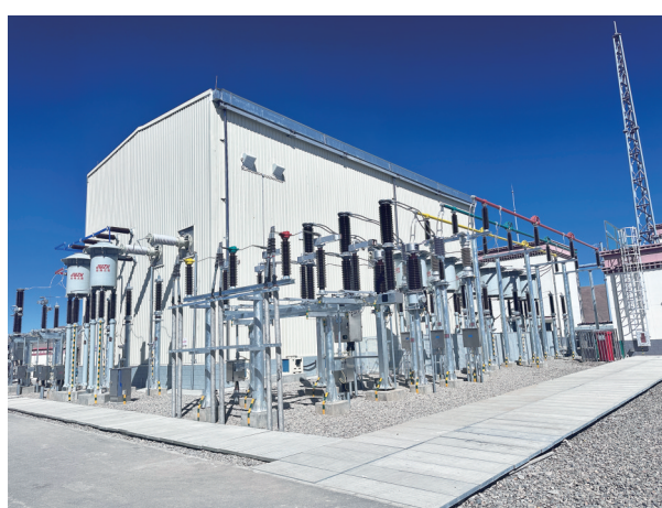
全国首套电网侧带超容构网型SVG阔厅外观(萨嘎站)。
