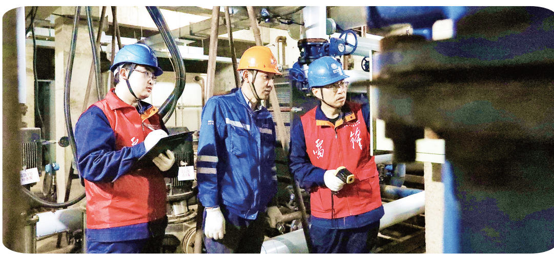
10月25日，在阜新鸿源热力有限责任公司新维玛瑞小区供热泵站，国网阜新供电公司工作人员正在对泵站换热机组电源等主要用电设备进行安全用电检查。张依娇/摄
