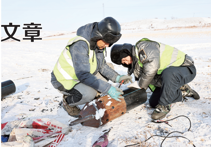
为推进风电项目工程进度，电建员工在冰天雪地中为铺设集电线路电缆做准备。王庆文/摄
