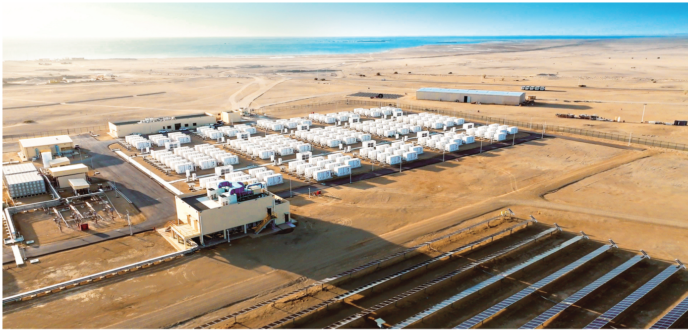
沙特红海光伏储能项目采用华为智能组串式构网型储能平台和华为智能组串式逆变器。华为数字能源/供图
