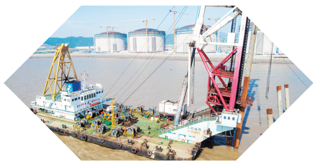
浙能舟山六横液化天然气(LNG)接收站项目码头钢管桩稳稳扎入海中。 朱信/摄
