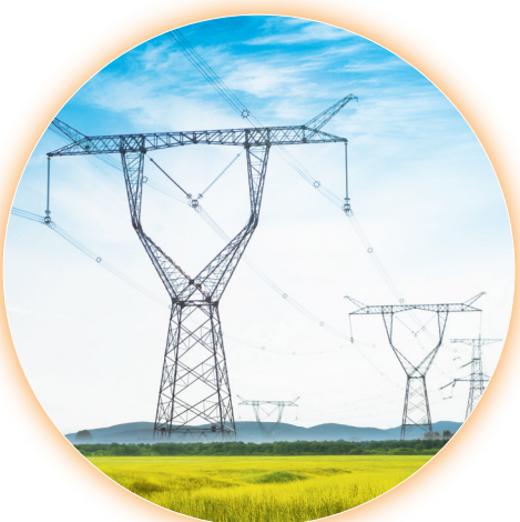
图为全国首条1000万千瓦特高压输电通道——1000千伏晋东南—南阳—荆门特高压交流试验示范工程。
