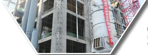
图为2019年1月18日,世界最大单炉日处理煤4000吨级超大规模水煤浆气化炉在兖矿能源荣信化工成功吊装。山东能源集团/供图
