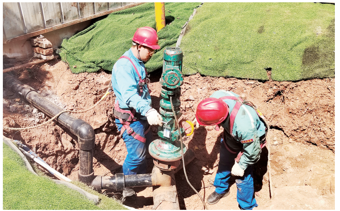
图为云南公司工作人员正在实施不停输带气作业。郑文贞摄
