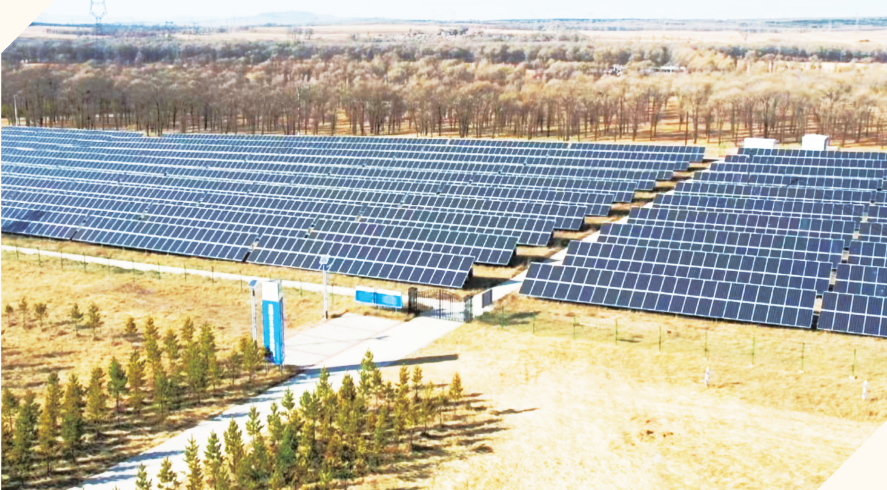
图为国家能源电力集团龙源电力右玉野场村、旗杆村光伏电站。
