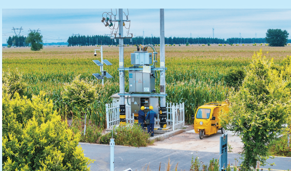
图为9月13日，国网安阳县供电公司员工对台区设备进行巡检，为即将到来的秋收做好供电保障。 张阳 张琳琳/摄
