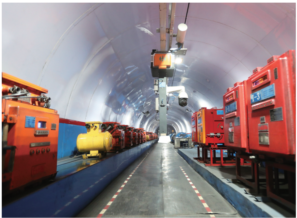
5G+智能化巡检机器人
