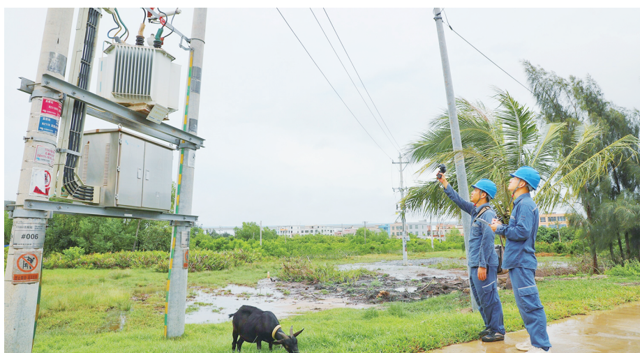
近日,海南电网海口供电局工作人员到北港岛开展巡视检查,对线路设备进行测温、记录,以保障设备安全稳定运行。 杨永光/摄
