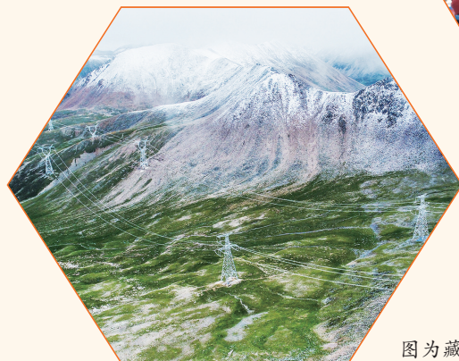
图为藏中电力联网工程。
