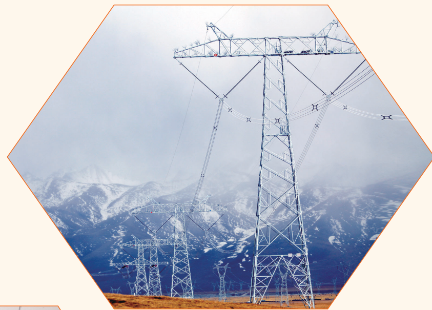
图为青藏联网±400千伏输电线路。
