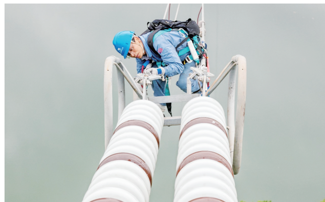
7月30日,南方电网云南送变电公司普洱版纳运检站工作人员在500千伏漫昆Ⅱ回线2号塔上检查均压环、连板螺栓紧固情况。张强/摄
