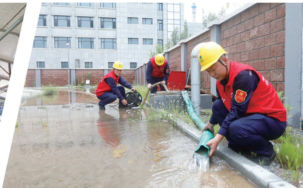
7月28日,国网辽宁电力(葫芦岛)雷锋共产党员突击队对变电站防汛排水情况进行巡查,保障电网安全稳定运行。 李娇/摄
