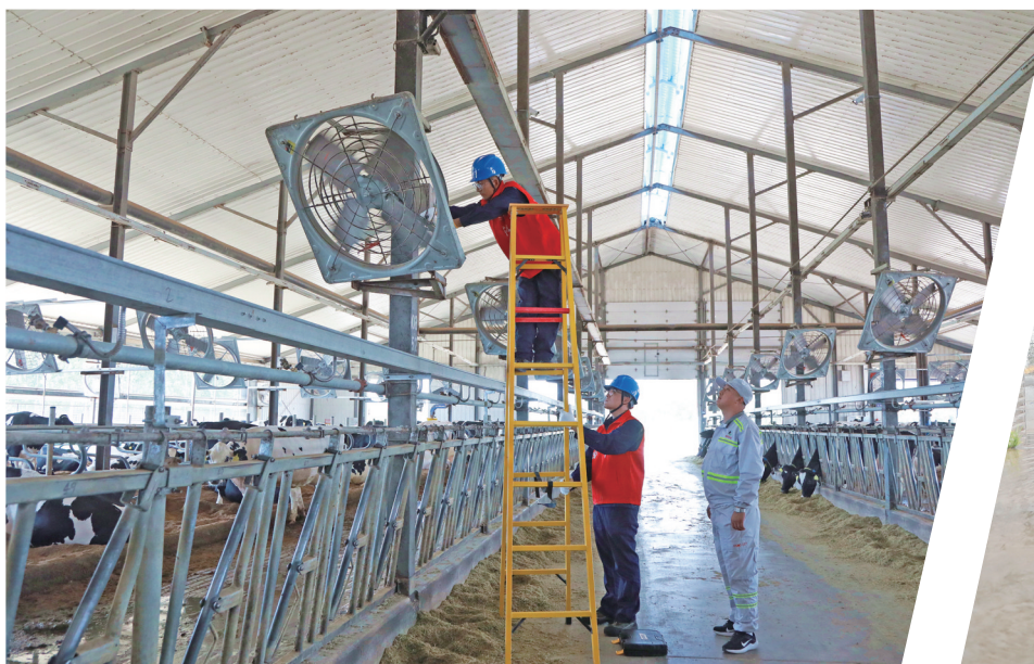
图为国网辽宁电力(阜新)雷锋共产党员服务队队员帮助客户检查牛舍排风机电运行情况。 魏晓丽/摄
