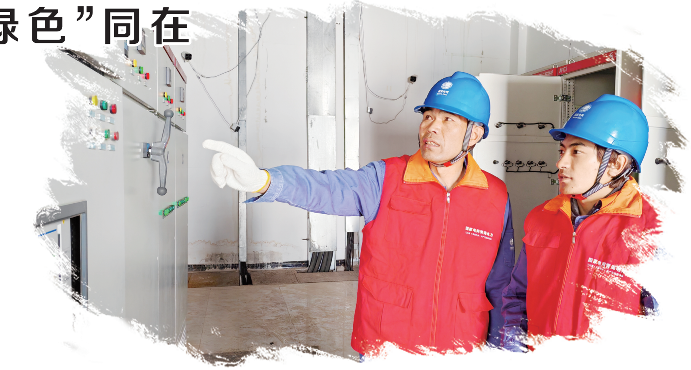
国网玛多县供电公司员工正在玛多县清洁取暖项目锅炉房的配电室内进行安全用电检查。王翌萌/摄
