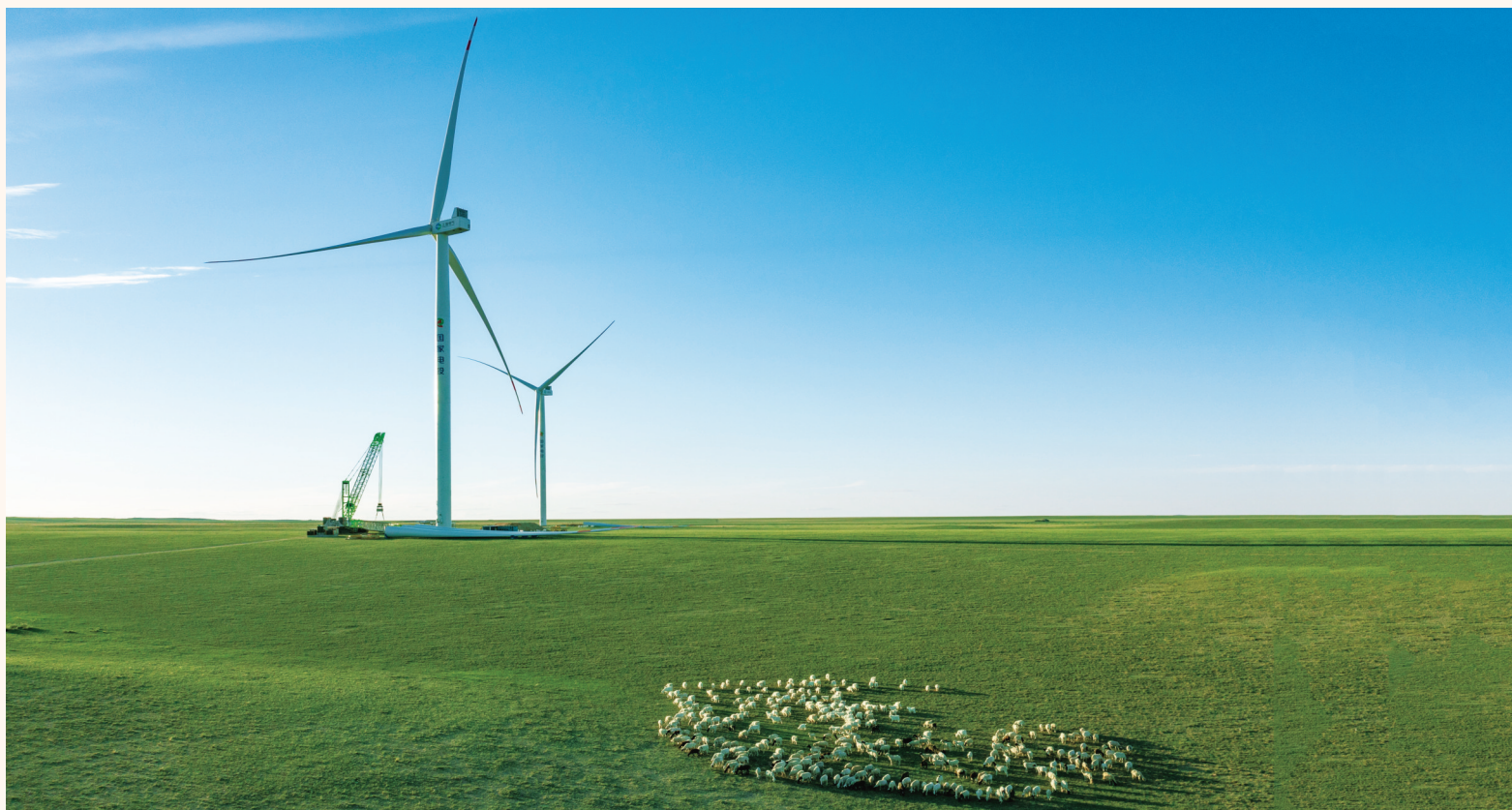
乌兰察布风电基地一期600万千瓦示范项目。国家电投内蒙古察哈尔新能源/供图
