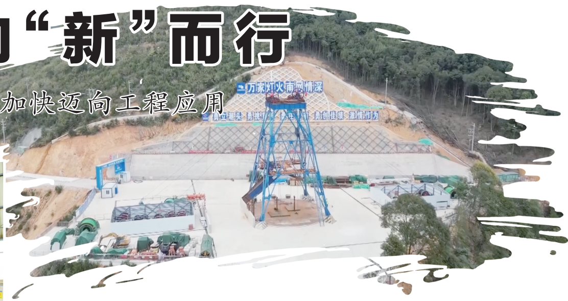
肇庆浪江抽水蓄能电站在我国水电领域首次引入“引水深竖井正井法”施工。南方电网公司/供图
