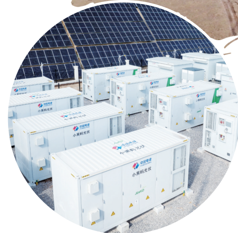
云南丘北小黑妈“光伏+储能”项目。晶科能源/供图
