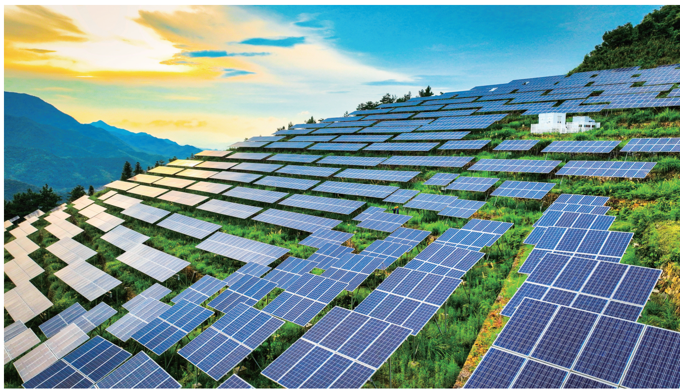
图为杭州临安潜川大龙田10兆瓦农光互补光伏电站。吴忱/摄
