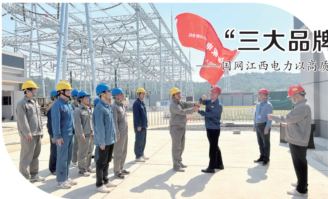
图为国网江西超高压公司吉安安瓷建设现场进行授旗仪式。李亚男/摄
