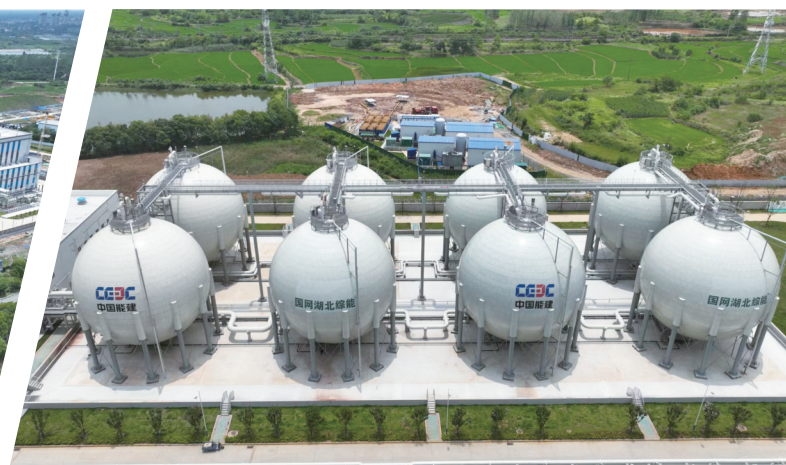
非补燃绝热物理储能系统核心装备大型储热罐。
