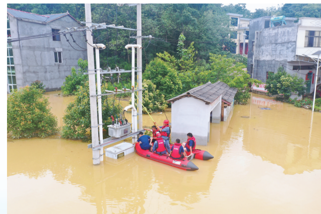
图为南方电网贵州兴仁供电局工作人员通过自动化开关操作启动自愈互供互倒模式,陆续恢复受灾区域线路供电。
