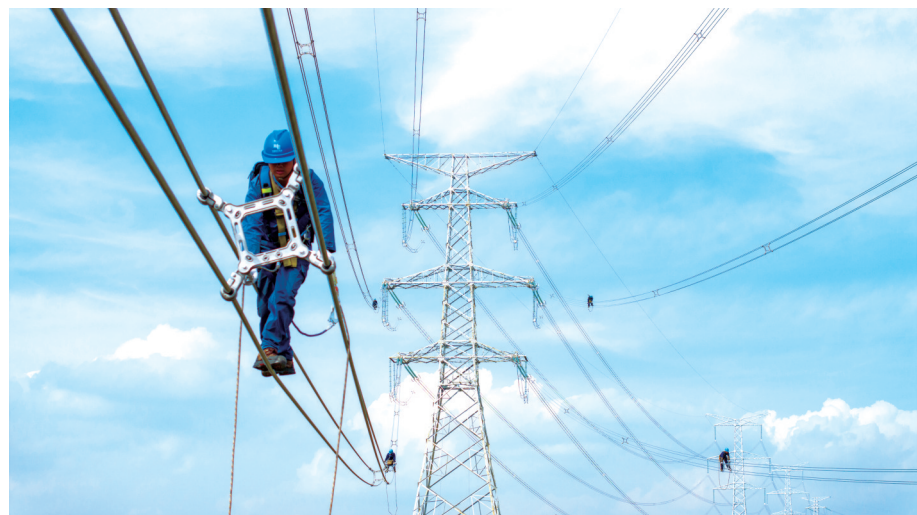
图为贵州电网公司员工开展走线放线工作。贵州电网公司/供图
