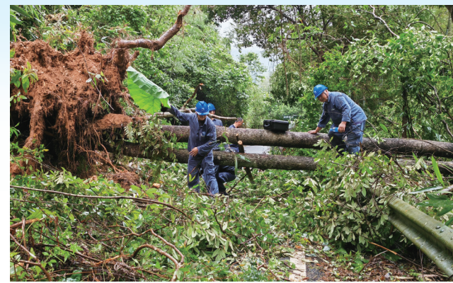
图为南方电网广西桂林兴安供电局溶江供电所抢修人员开展线路巡视及线路受灾情况核实。
